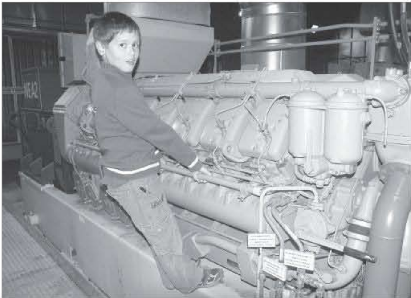
An Opas früherem Arbeitsplatz im Bunker Erwin durfte sich Nieland-Enkel Yannick umsehen. Die Diesel-Aggregate im Klimabunker beeindruckten den Achtjährigen besonders.
